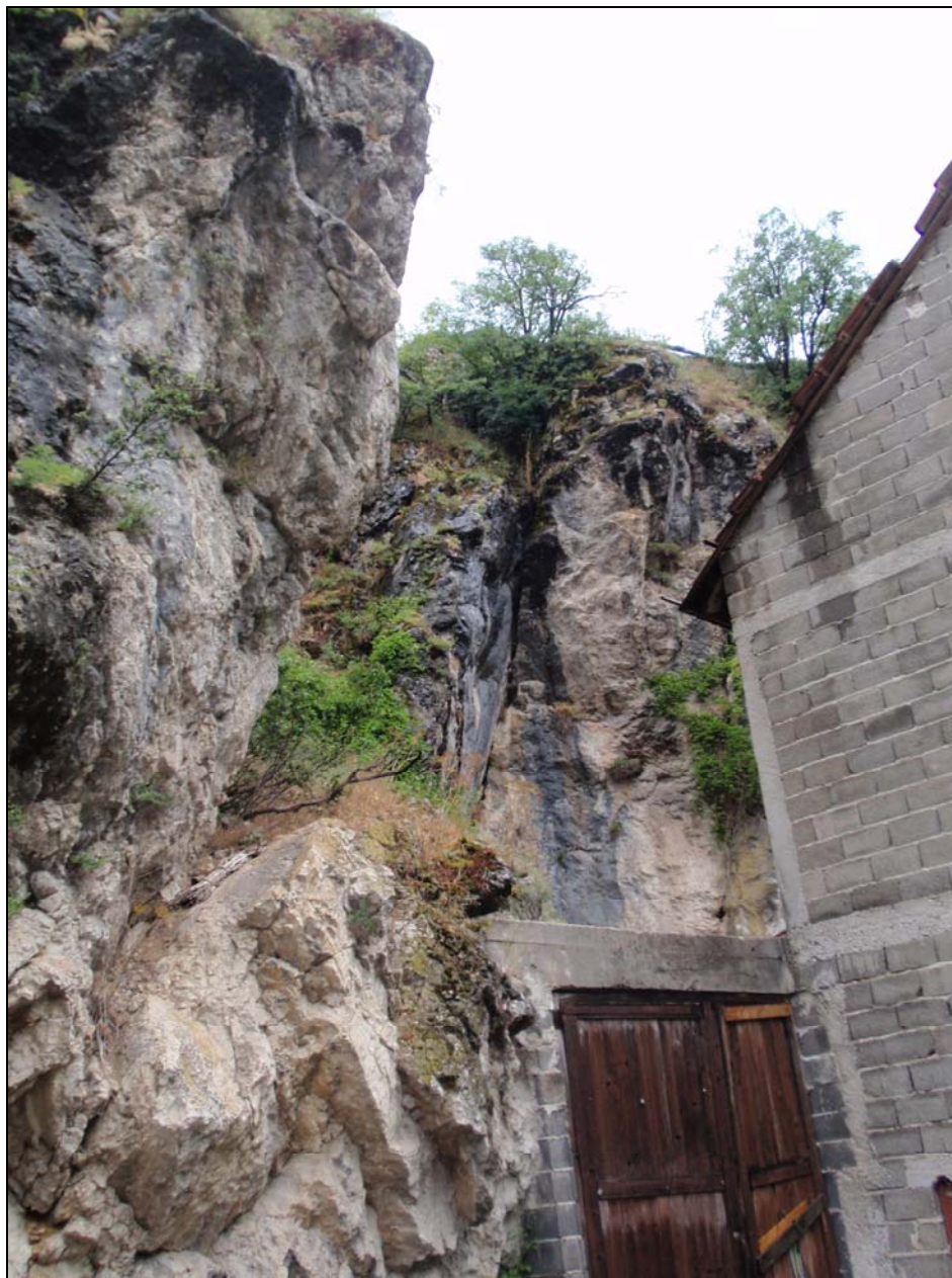
Slika 3. Pukotine u vapnenačkom masivu
