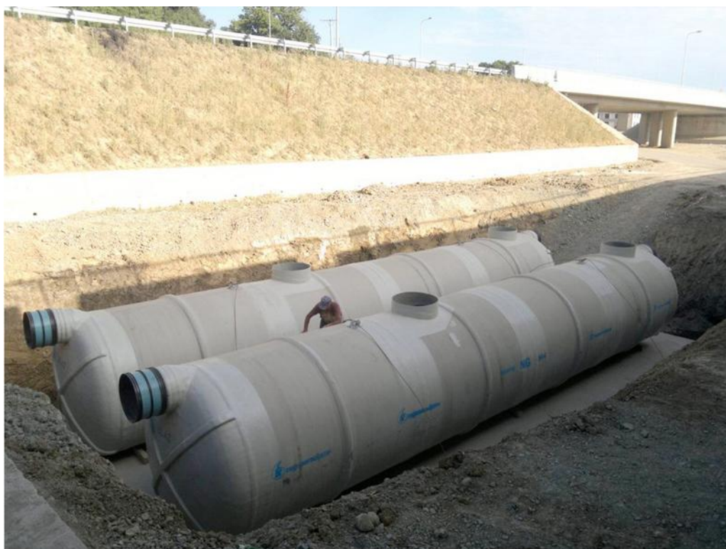
Slika 5. Aquareg NG 500, između ostalih separatora tipa Regeneracija, je ugrađen na Mahovljanskoj petlji jula 2012, kao dionici autoputa Banja Luka - Doboj i Banja Luka - Gradiška. Na projektu Mahovljanske petlje izgrađeno je sedam objekata, odnosno mostova i nadvožnjaka različite dužine. Mostovsku odvodnju na 5 mostova je takođe radila Regeneracija d.o.o.
