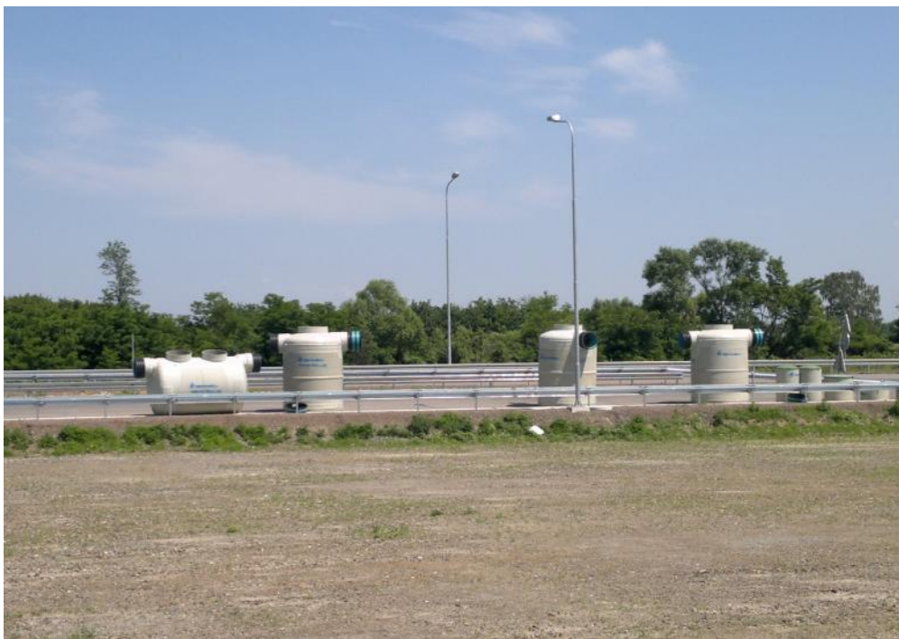
Slika 4. Separatori ulja, Autoput Banja Luka
