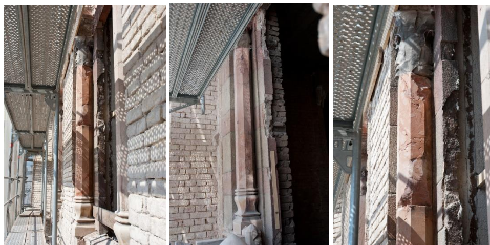
Slike 9.-11: Stub od crvene breče uz vrata i veliki prozorski otvor - zatečeno stanje, pukotine u tijelu stuba, odlamanje komada i destrukcija nadkapitela (foto: HM-Tenax)
