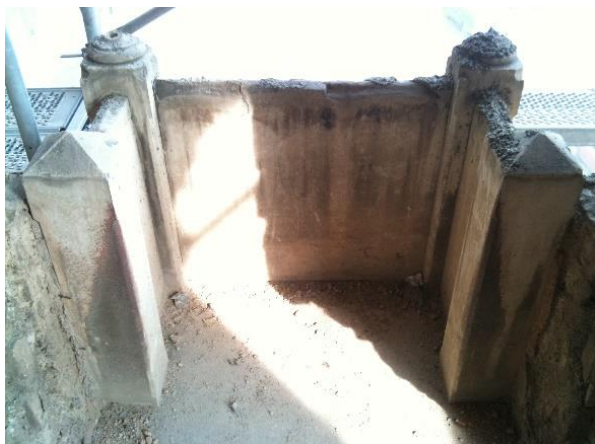
Slika 2: Element kamene ograde - zatečeno stanje - nedostajući dijelovi, fragmentiranje, pukotine, vitoperenje elementa (foto: HM-Tenax)
